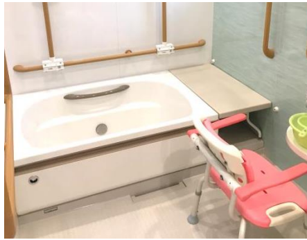
浴室。ご利用、介助がしやすいように可動式の手すりを設置
