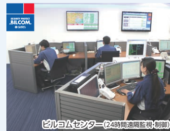
ビルコムセンター(24時間遠隔監視・制御)
