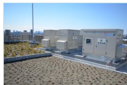
屋上に設置されている「ガス発電機」
